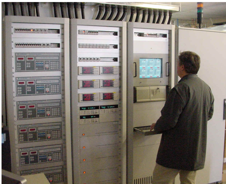
Fig. 2 - Vista d'insieme degli armadi contenenti l'hardware di gestione e controllo, la strumentazione, l'hardware di acquisizione, le protezioni, il PC di supervisione.
