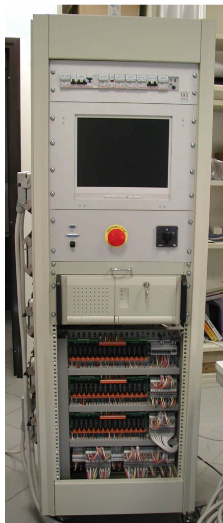
Fig. 1 - Foto dell'armadio (realizzata durante le fasi di test). Sono visibili in basso i banchi relé per il completo isolamento dei segnali.
